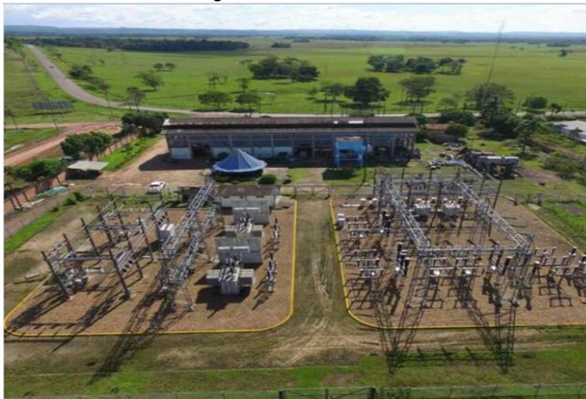
Imagen 2: Subestación San José
